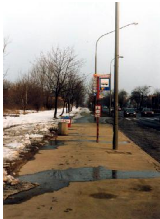
Fot. 5. Ścieżka przy ul. Wilanowskiej. Przykład złego projektowania – ścieżka przecina powierzchnię przystanku autobusowego. Elementy wyposażenia przystanku stwarzają zagrożenie dla bezpieczeństwa ruchu.
