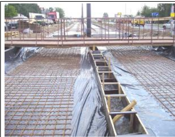
Fot. 2. Przykład koryta trasy tramwajowej wyłożonego matą podtorową i przygotowanego pod układanie podkładów betonowych
